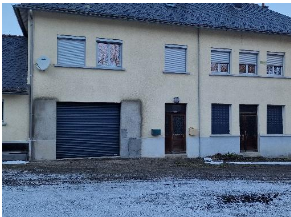
Pose d'une porte de garage et isolation des combles de l'ancienne école de Chambeuil
