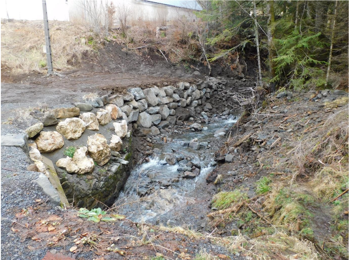
Renforcement de la rive du ruisseau de Gouyère au pont de l'Usine
